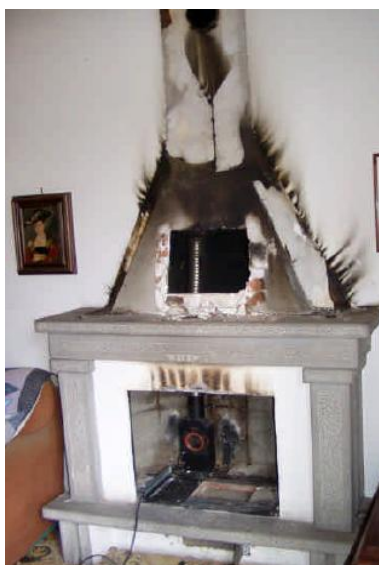
Fig. 2.1 – Esempio di caminetto dopo un incendio.
